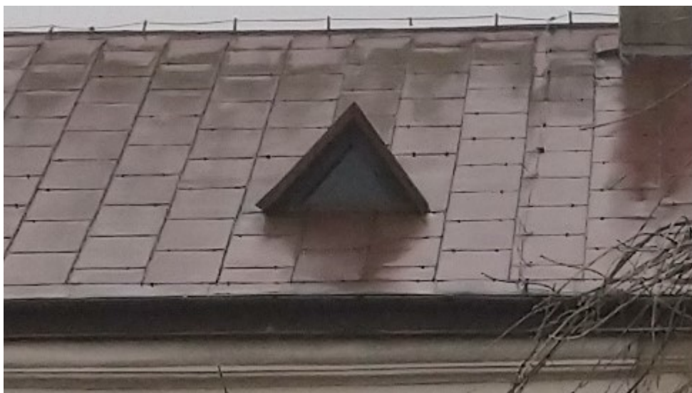
Fot. 2. Świetlik dachowy do zrekonstruowania
