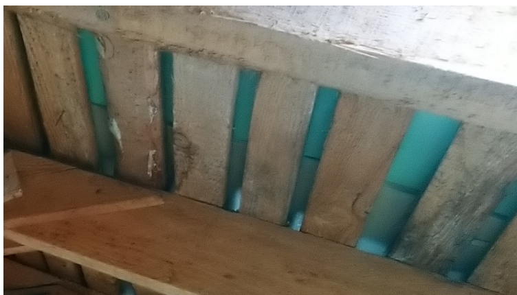
Fot. 1. Ubytki w deskowaniu do uzupełnienia
