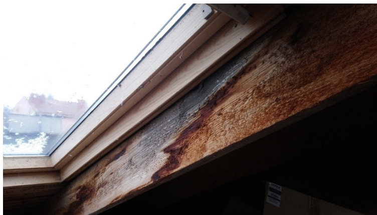
Fot. 3. Fragmenty niektórych krokwi wymagających zabezpieczenia
